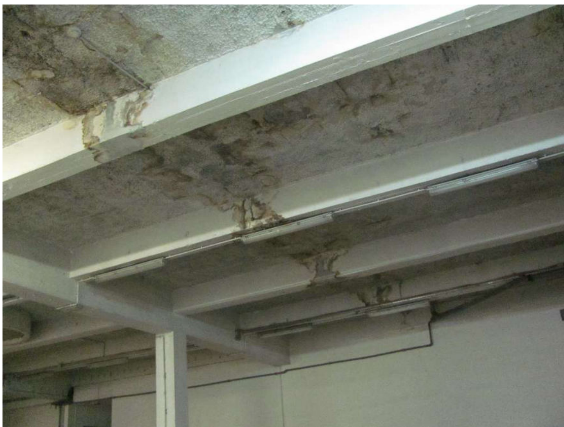
Mrlje od vlage i plijesni i oštećenja na stropu garaže
