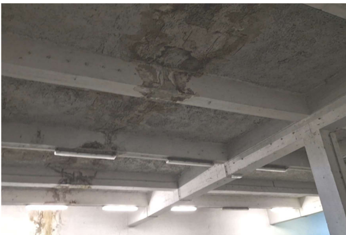
Mrlje od vlage i plijesni i oštećenja na stropu garaže
