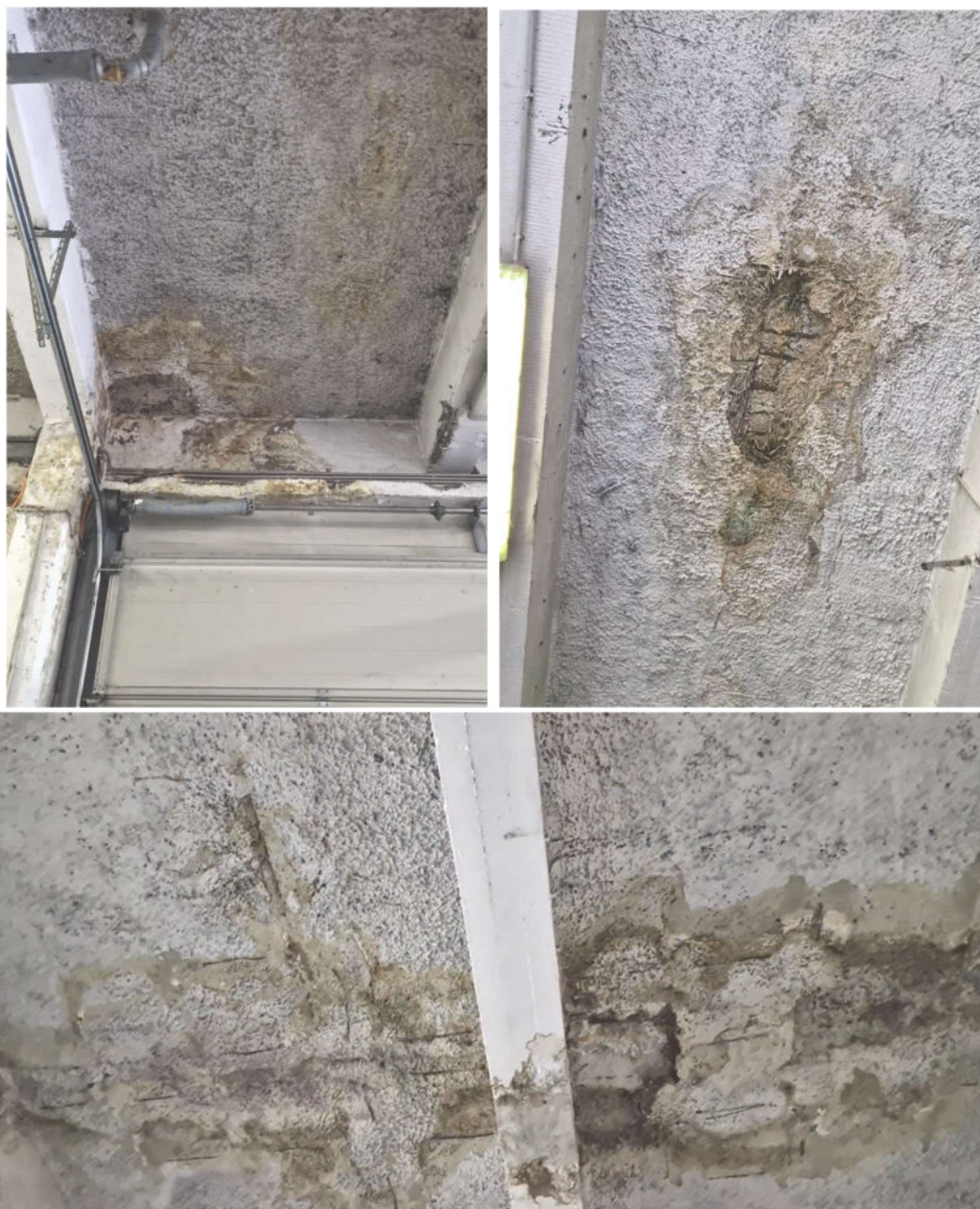
Mrlje od vlage i plijesni i oštećenja na stropu garaže
